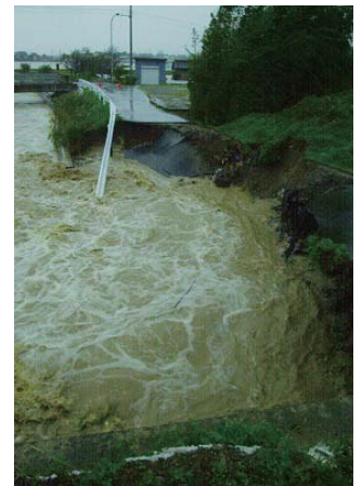
崩壊した県道（黒谷川堤防）
